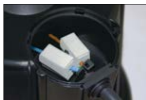
Złączki HelaCon Lux w puszcze łączeniowej podłączone do źródła zasilania.
